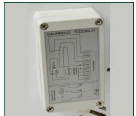
CAIXA DE ALARME
